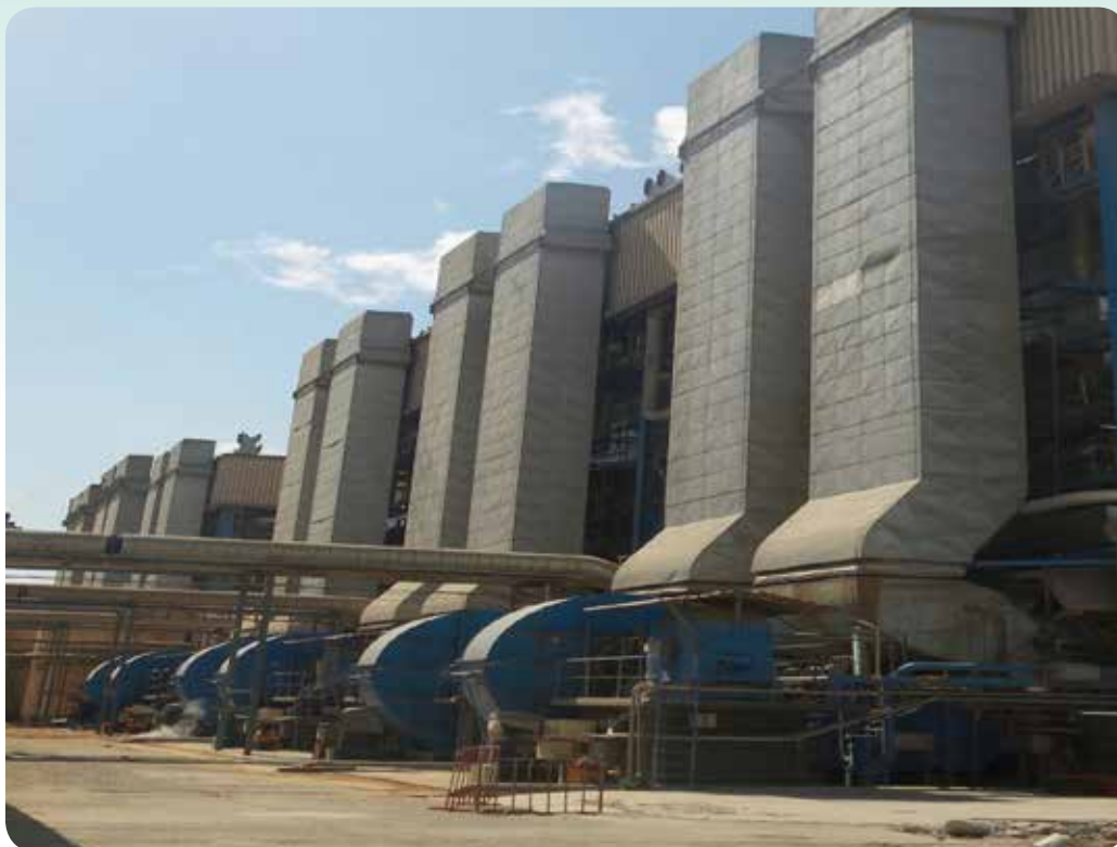
غلايات محطة الشعبية Al Shuaiba Station Boilers
