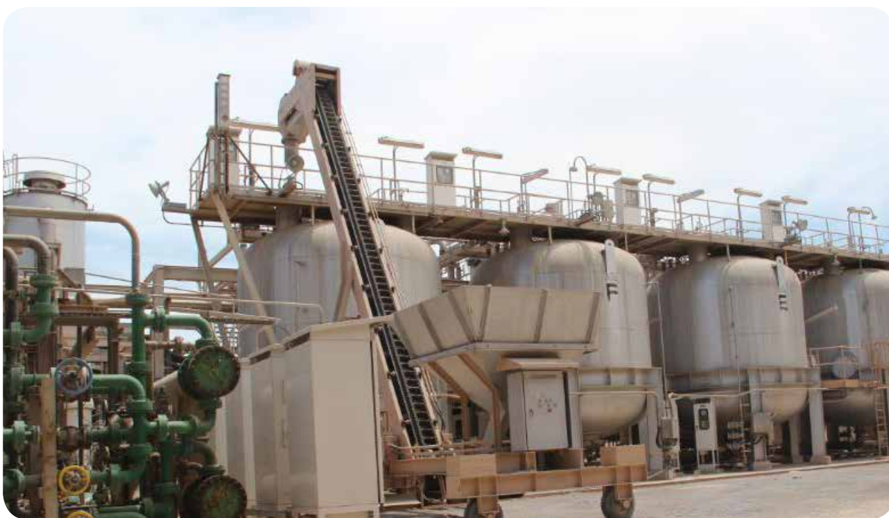
وحدة إعادة الكربنة لمعالجة إحمرار المياه Re-carbonation unit to treat water redness
