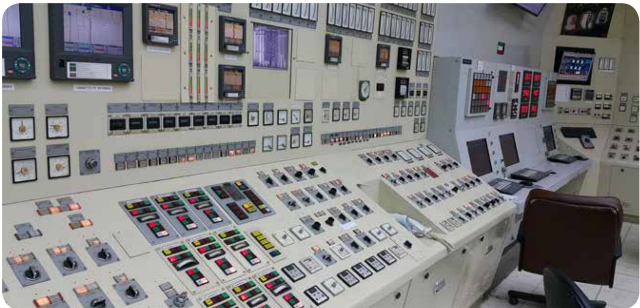
غرفة تحكم التوربينات Turbine Control Room
