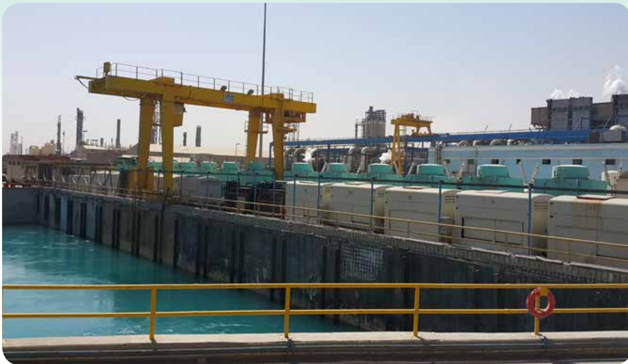
حوض تجمع مياه البحر (محطة الشعبة) Sea water pool basin (Al Shuaiba station)
