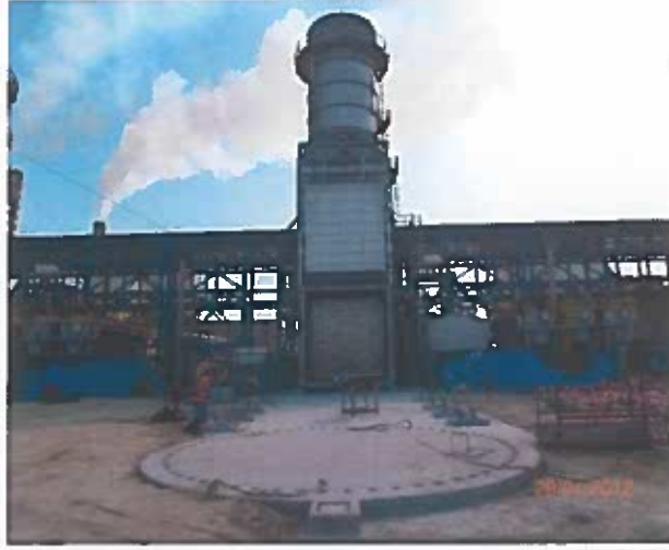
منطقة الغلاية التي تعمل بنظام الاسترجاع الحراري للوحدة 12 HRSG Unit 12 Area
