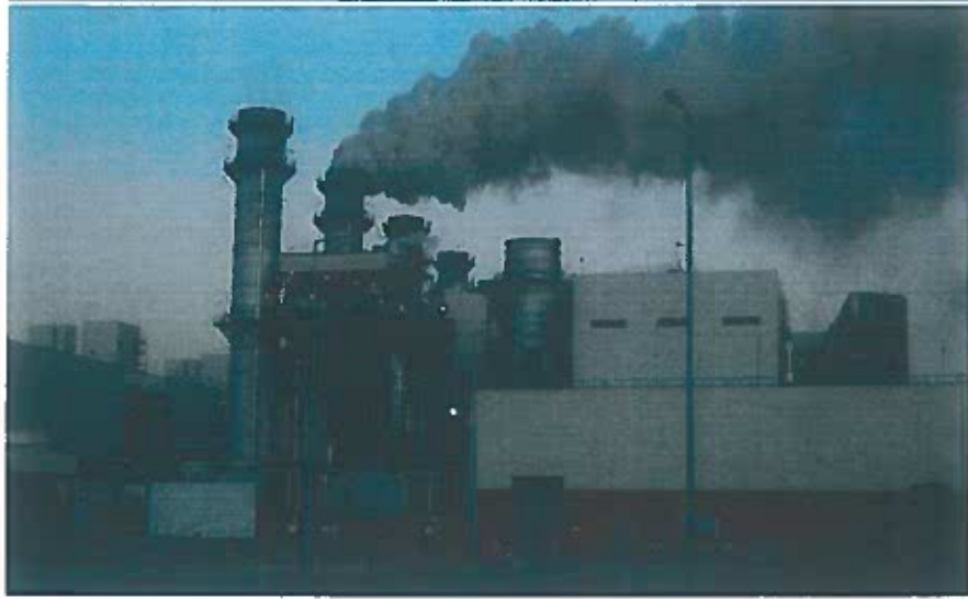
المدخنة الرئيسية لعدم الغازات الخارجة من تنظيف (نفخ) مواسير الغلاية رقم 12 التي تعمل بالاسترجاع الحراري HRS #12 Main Stack Sigma Blowing
