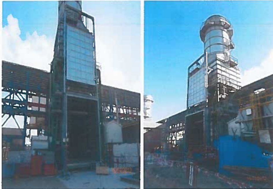
أعمال التركيبات لبوابة تحويل الغازات للوحتين 22 و31 Erection Works for Diverter Damper Units 22 & 33
