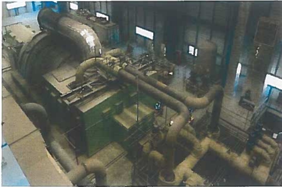
مولد الوحدة البخارية رقم 1 (طابق تشغيل) Steam Turbine Generator # 1 (Operating Floor)
